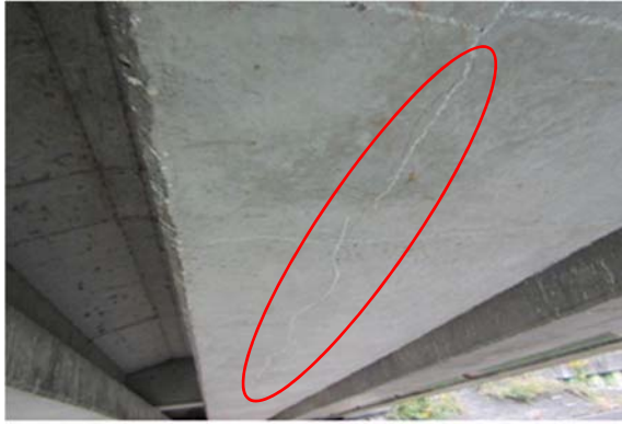
■ コンクリート床板のひび割れ
