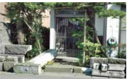
地震で倒壊したブロック塀 (新潟県中越沖地震)
