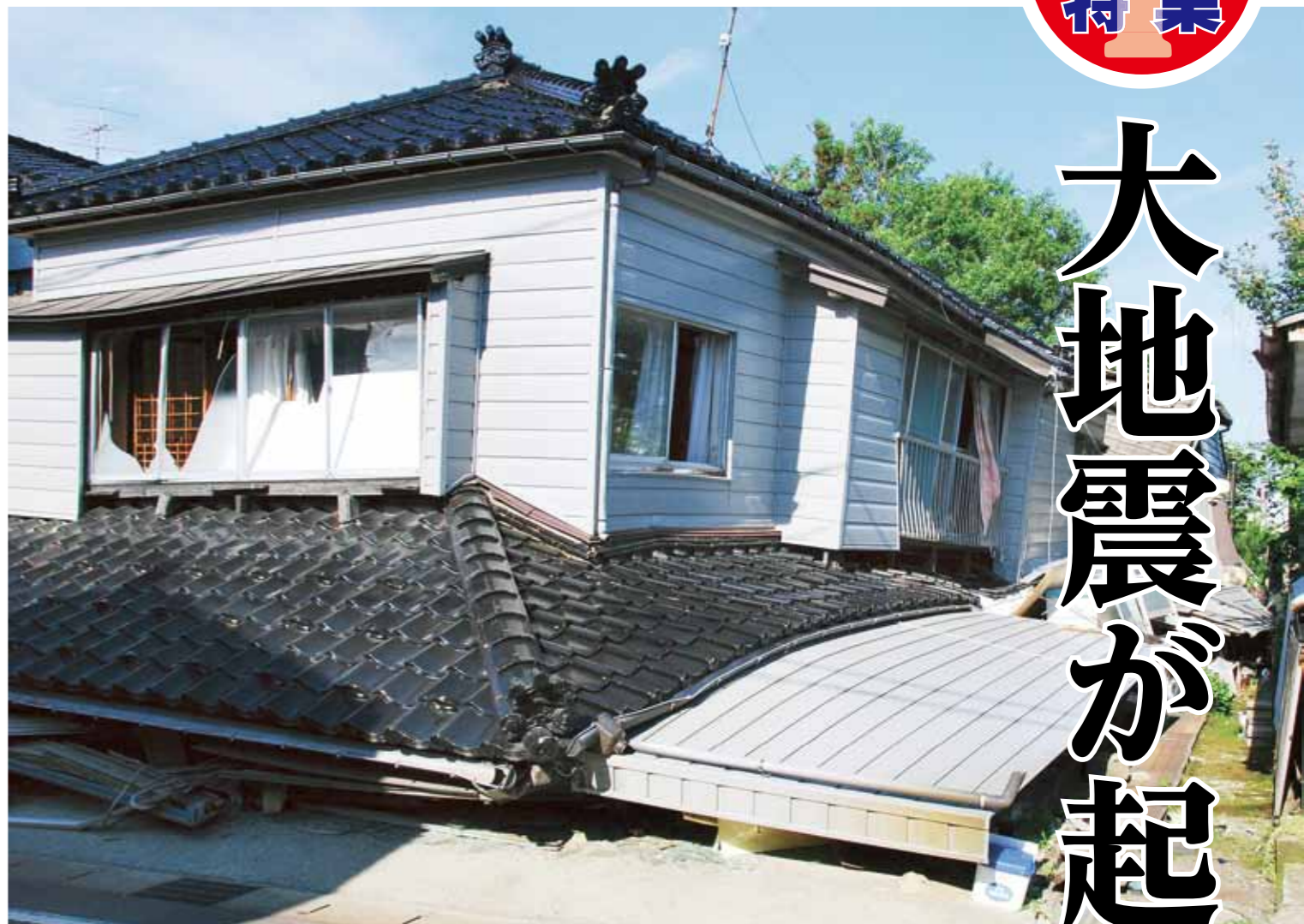
地震により倒壊した家屋 (写真は2007年に発生した新潟県中越沖地震のもの)
