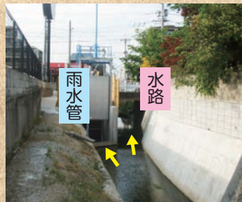
▲雨水取込施設 大量の水が流れると雨水管へと流れる仕組み
