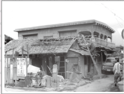
▲改築される「しみせ」(昭和44年3月) 手前が下高野街道。中央に道標と墓石が建つ。右は天美商店街への道 (岸田充三郎氏提供)。
