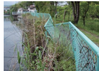
ネットフェンスの転倒
