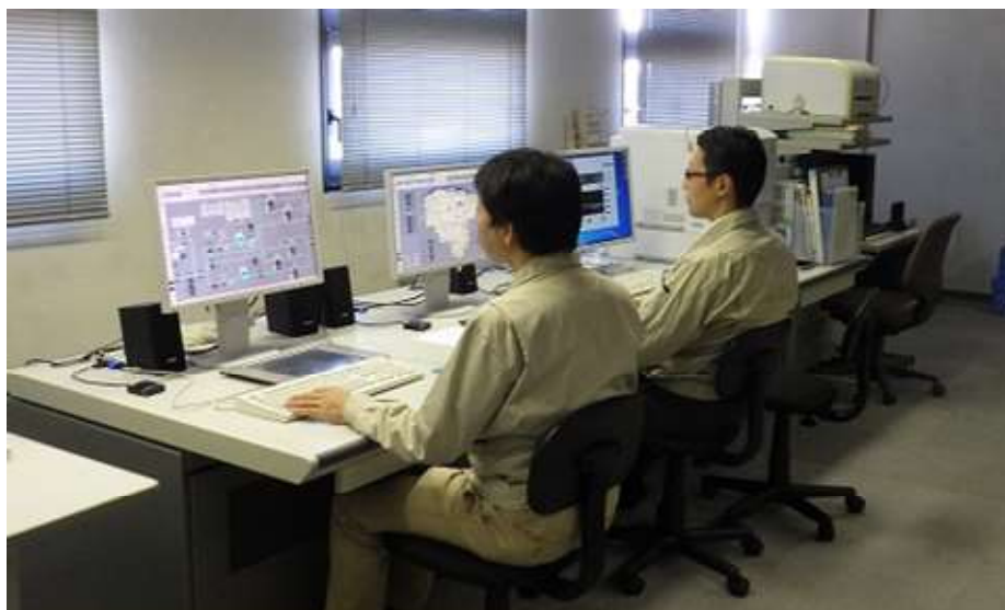
写真5.2.1 中央監視室（市役所庁舎）
